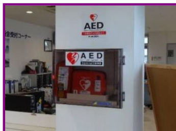
《写真4》ショールームにAEDを設置
